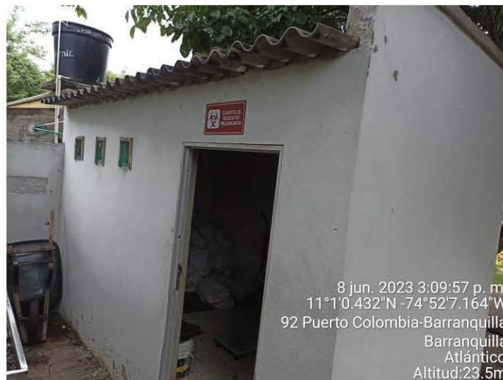
Fotografía No. 1 –Cuarto de RESPEL –CENTRALCO LTDA.
